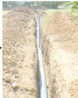
6. ท่อจ่ายน้ำ
